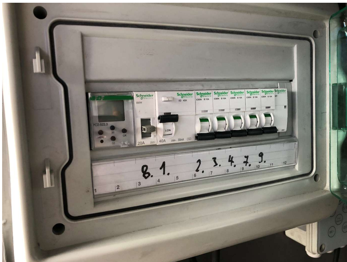
Bild der Schalter in der Schalttafel
